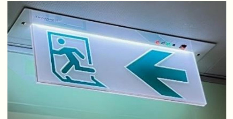
緊急出口指示標誌設有照明
